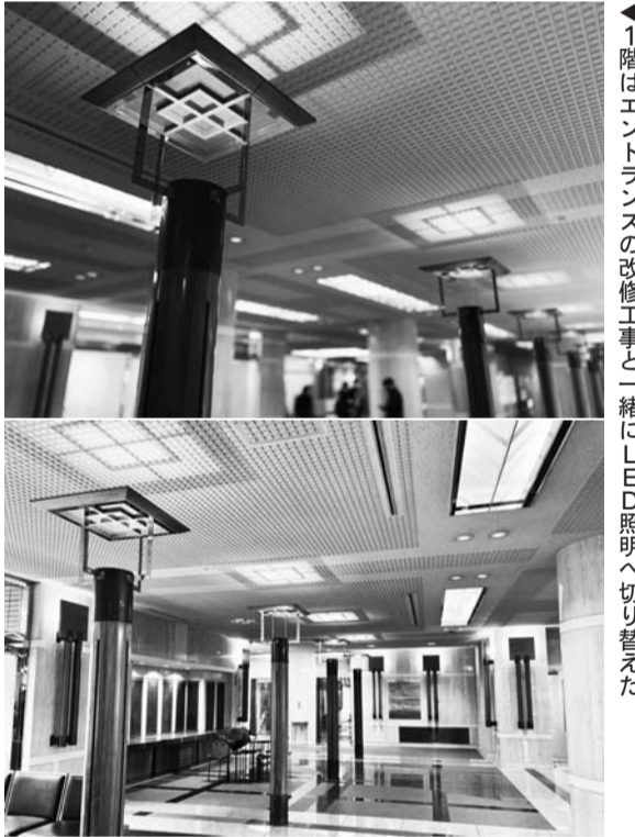
1階はエントランスの改修工事と一緒にLED照明へ切り替えた
